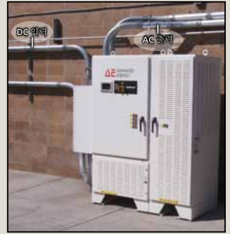
Cline Cellars에 설치된 AE Solaron® 333 kW 인버터
